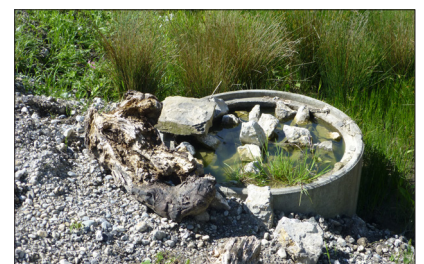
Abb. 11: Oberriet, Unterkobel: Betonschacht nach 5 Jahren Betrieb. (J.Barandun)
