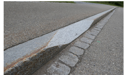
Abb. 6: Örtlich abgeschrägter Randstein zur Erleichterung der Abwanderung von der Fahrbahn. (J. Barandun).
