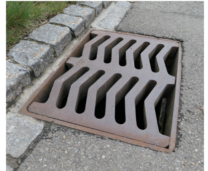
Abb. 3: Schachtdeckel mit grosser Schlitzbreite und direkt am Randstein. Kleintiere fallen mit grosser Wahrscheinlichkeit in den Schacht. Der Randstein ist 3-4 cm hoch und lückig verbaut. So bietet er Möglichkeiten zum Verlassen der Fahrbahn. (J. Barandun)
